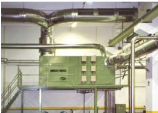
Filteranlage mit SMOG-HOG® SH-60/2/Tandem, integriertem Tropfenabscheider zur Abscheidung von Kühlschmierstoffnebel. Absaugung von 32 Werkzeugmaschinen.
