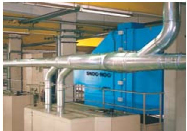
SMOG-HOG® SH-100/TR mit integriertem Tropfenvorabscheider für Luftleistung 20.000 m 3 /h zur Absaugung von Emulsionsnebel an 6 Bearbeitungszentren und Luftrückführung.
