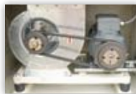
Ventilator mit Motor
