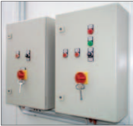
Schaltschrank mit Funktionstasten
