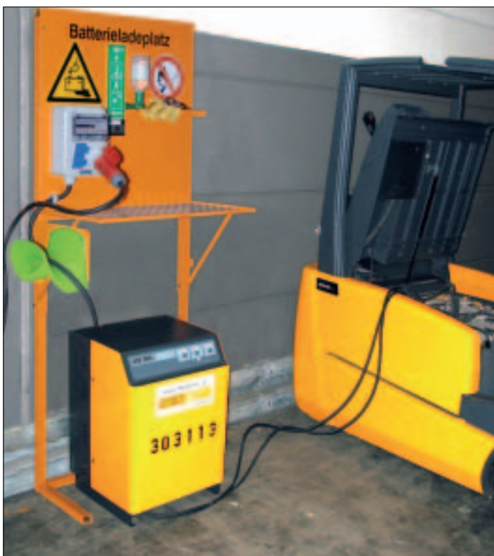
Typ BL mit CEEform Steckdose 400 V beim Aufladen eines Elektro-Gabelstaplers
