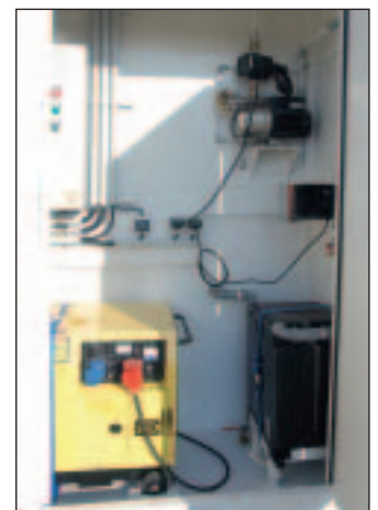
Technikraum mit Ventilator, Schaltschrank und Notstromaggregat
