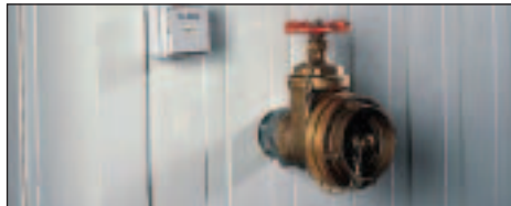
Anschluss für Schaumlöschanlage
