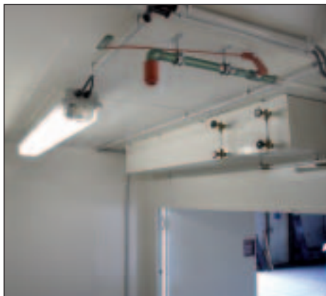
Notdusche mit 250-Liter-Tank und ex-Beleuchtung
