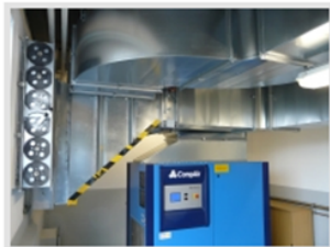
Zwei PureAir-Verdichter erzeugen ölfreie Druckluft für die Produktion bei Pharma Wernigerode.
